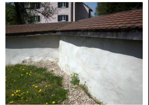
Mit einer Regenabdeckung aus Ziegeln ist die restliche Mantelmauer heute versehen. Ihre Stärke von 1 m ist noch immer beeindruckend, und ihr Verlauf lässt den Umfang der Anlage noch heute erkennen.
