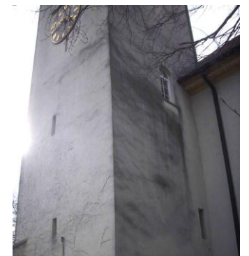
Der dem 14. Jahrhundert entstammende, mit Schlitzscharten ausgestattete Turm wurde arg überformt, und ein dicker Putzauftrag im 20. Jhd. Gab seinem ursprünglichen „Styl“ den Rest.
