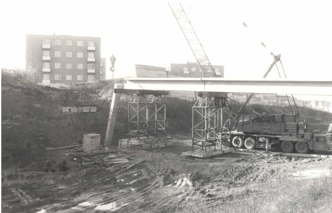
Výstavba lávky pro pěší nad budoucí Spořilovskou spojkou u polikliniky Spořilov v roce 1986
