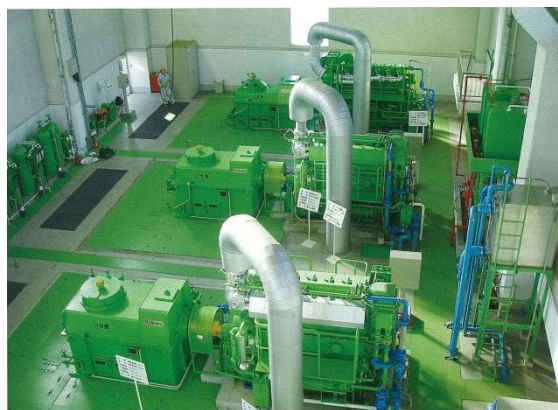
ポンプ室フロア
