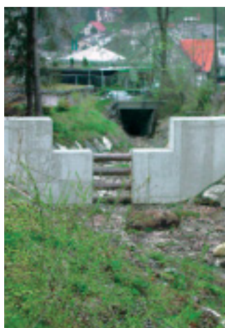
Was der Werdbach an Bäumen und grösseren Steinen mitreisst, fangen zwei Grobrechen vor dem Einlauf der Dole auf. Laut Berechnungen von Fachleuten sollte das Wasser auch dann durchfliessen können, wenn die vertikal und horizontal liegenden Pfosten mit grobem Geschiebe gefüllt sind.
