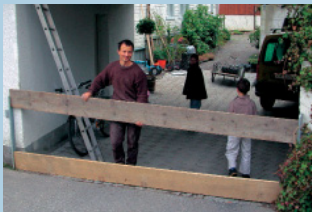
Robert Dietz montiert die Dammbalken, die das Wasser daran hindern sollen, in seine Gärtnerei einzudringen.
