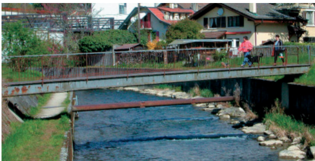
Der Unterlauf der Versoix im April 2002. Der Fluss ist durch Betonmauern kanalisiert, ein Abwasserrohr quert ihn nahe vor dem Steg – eine potenzielle Gefahrenstelle bei Hochwasser.
