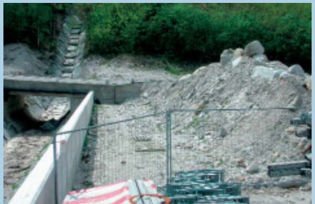
Eine neue Mauer entlang der Bachrinne hindert den Schlamm, auf das Firmengelände zu dringen.
