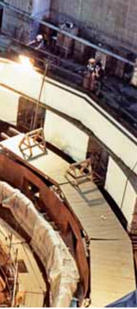
Das erste Laufrad für Itaipu trifft auf der Baustelle ein. Nach der Fertigstellung 1988 ist Itaipu das leistungsstärkste Wasserkraftwerk der Welt.
